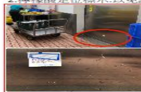
不銹鋼區隔門板: 底部髒汙
